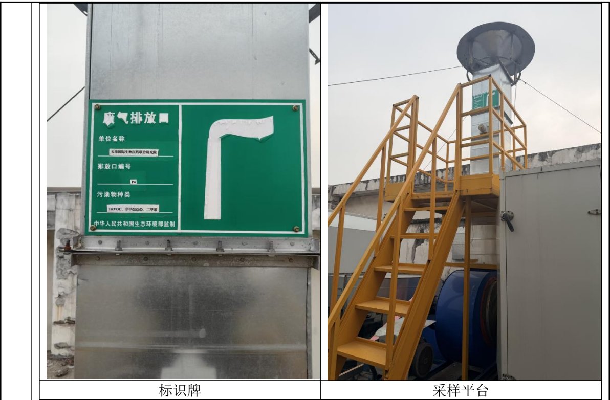
图 2-10 P4 排气筒设置情况
